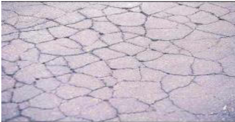
Foto N°1: Grieta Tipo Piel de Cocodrilo
