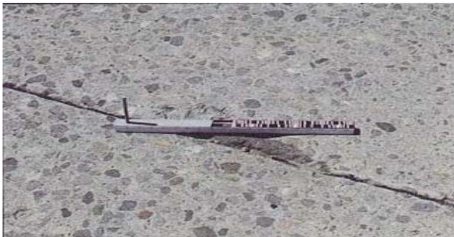
Foto N°1: Saltadura de grieta
