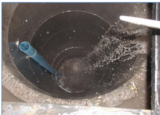
Figura 5.5-6 Pozo de infiltración semiprofundo
