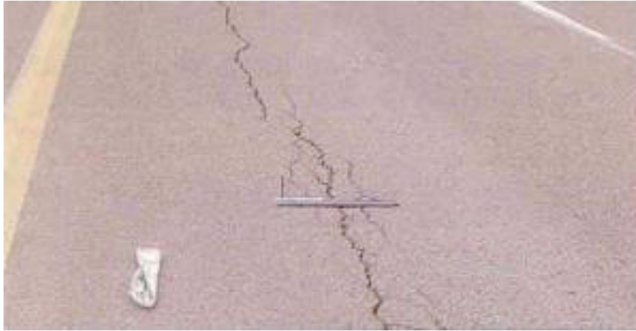
Foto N°1: Grieta Estructural Lineal
