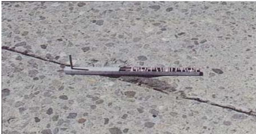
Foto N°1: Saltadura de grieta
