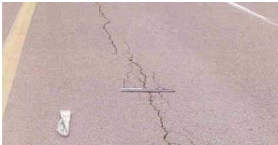
Foto N°1: Grieta Estructural Lineal
